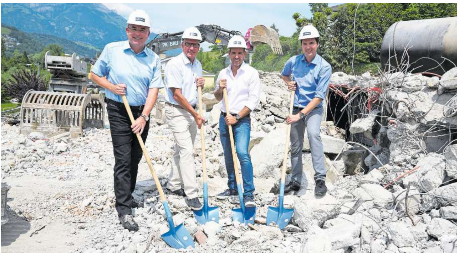
Spatenstich zur Wohnüberbauung Belvoir Sachsels. Gemeinsam hoffen sie auf gutes Gelingen; von links: René Affentranger (Eberli Sarnen AG), Gemeindepräsident Peter Rohrer, Architekt Björn Britschgi und CEO Alain Grossenbacher (Eberli). Bild: Romano Cuonz (Sachsels, 22. Mai 2018)
